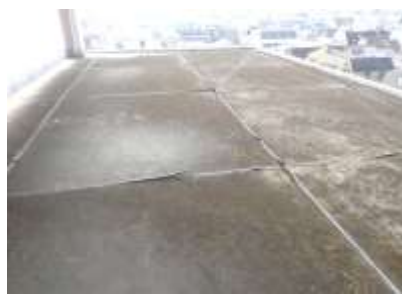
屋上の目地浮き(平成30年度修繕予定)
