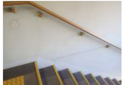
階段壁面のひび割れ(各階にあり)
