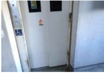
エレベーター入口の傷、サビ
