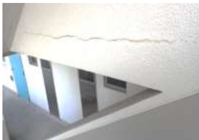
階段壁のひび割れ
