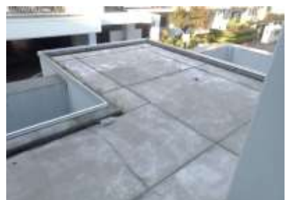
屋上のひび割れ
