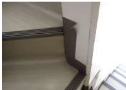
階段幅木の剥がれ
