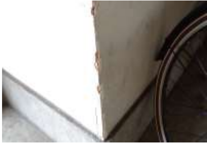
エントランス柱の破損
