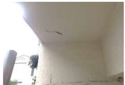
ベランダ天井の鉄筋露出
