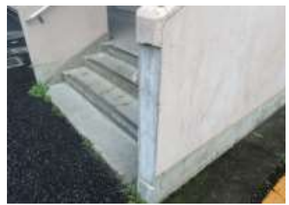
階段壁面の破損(平成30年度修繕予定)
