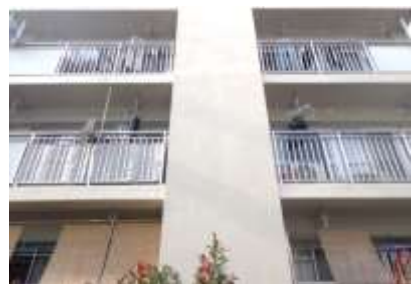
外壁のひび割れ(修繕済み)
