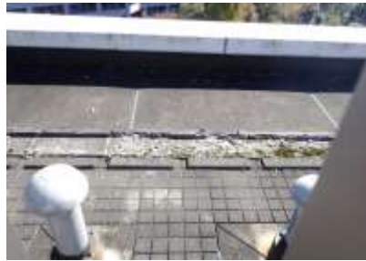
屋上床の破損
