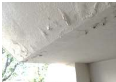
階段天井の塗装剥がれ
