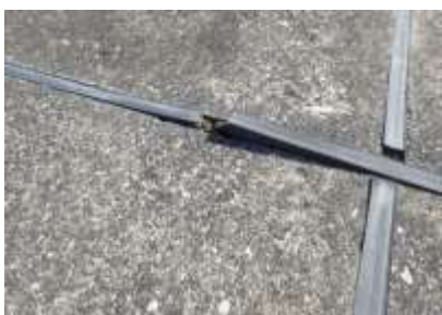
屋上の目地浮き
