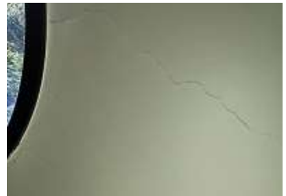
階段壁面のひび割れ
