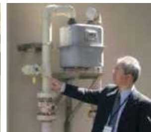
⑤ガス変換器の接続口
