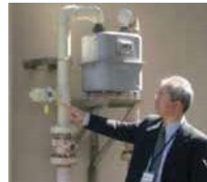
⑤ガス変換器の接続口
