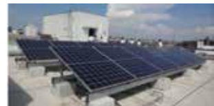
⑤自立運転可能な太陽光発電設備
