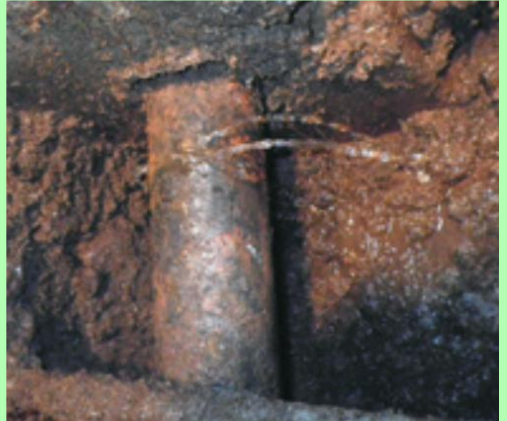
古くなって漏水している管
