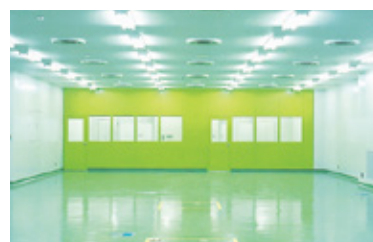
乱流方式クリーンルーム
