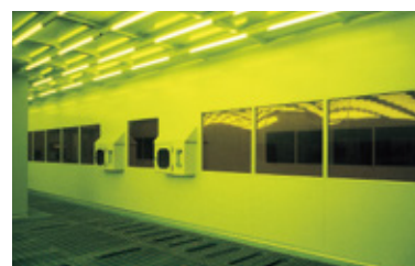
垂直層流方式クリーンルーム
