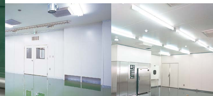
【CR-1、SAT】 壁パネルと一体化したリターンダクト。【CR-1、PAT】
