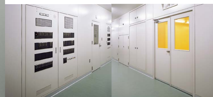
【CR-1】 制御盤を内蔵した壁パネル。
