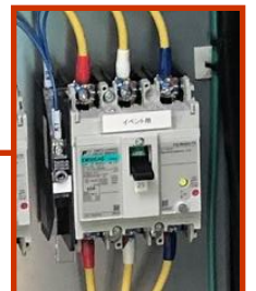
イベント用 ブレーカー 40A/200V (要電気工事)
