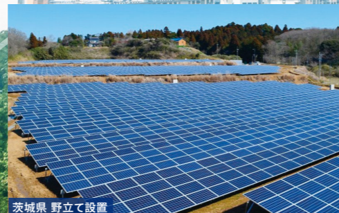
茨城県 野立て設置
